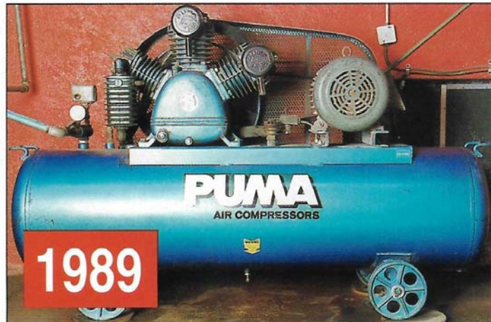
COMPRESOR DE AIRE, MARCA: PUMA, MODELO: TPP-100, POTENCIA: 10 HP, TRES CILINDROS PUMA MOD TPP-100 10 HP AIR COMPRESSOR
