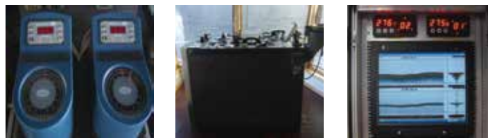
Girocompás ubicado en el puente de mando del Barco
